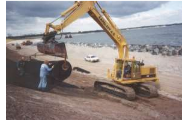
Erosiemat gewapend gras dijkhelling, Zeeland
