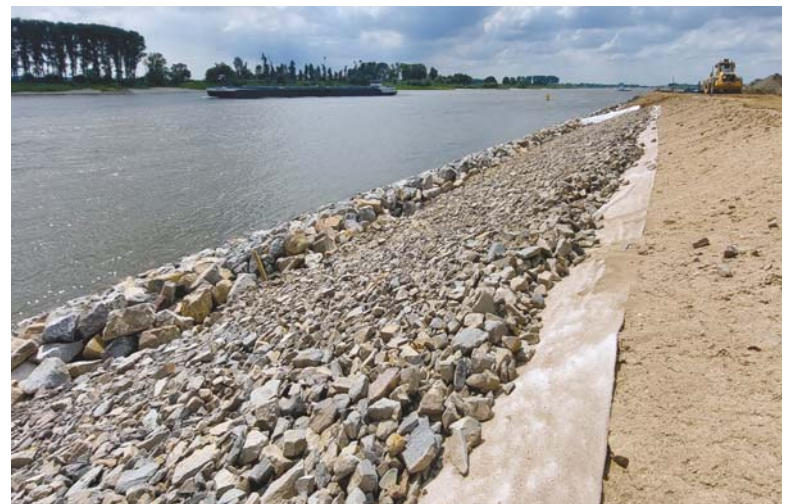
Figuur 2 – Voorbeeld van een goed aangelegde filterconstructie in uitvoeringsfase met het gebruik van hoogwaardig nonwoven kunststof geotextiel met hierop een steenbekleding in oplopende gradaties. (Boskalis / Naue)
