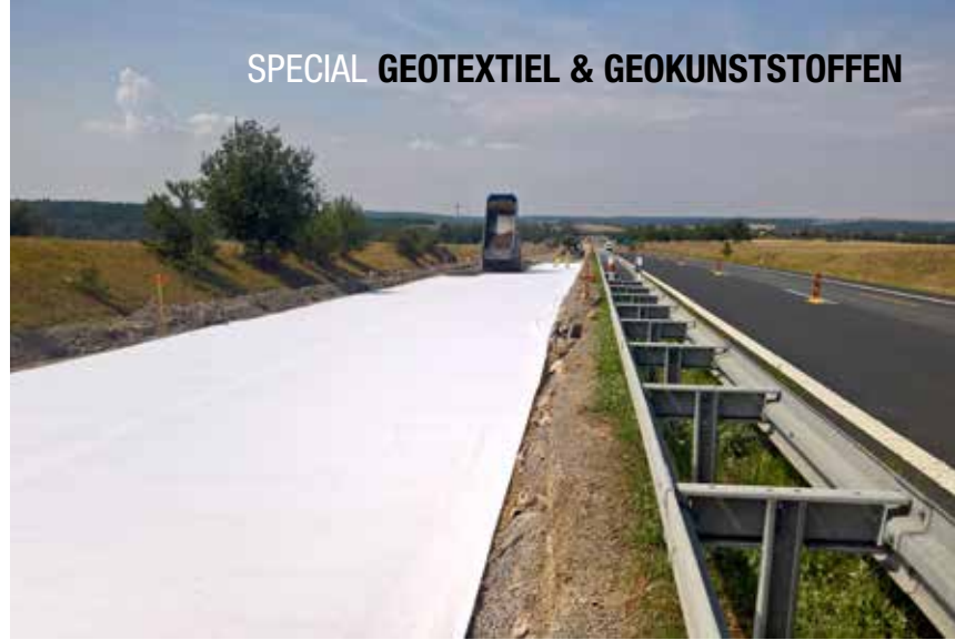
Geokunststoffen -miniem of juist met enorme afmetingen- zijn in de grond-, weg- en waterbouw niet weg te denken.
