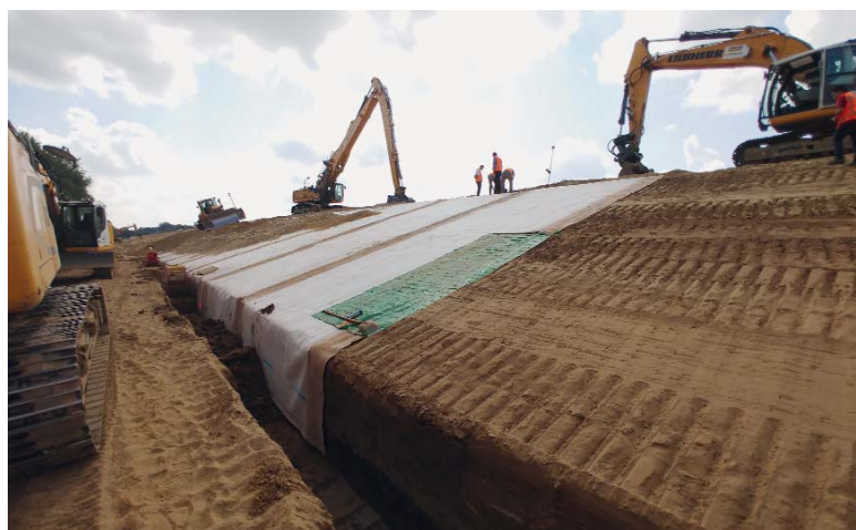
Figuur 8 – Aanleg bentonietmat op een waterkering als kunstmatig waterremmende laag. Referentie: Kees Dorst
