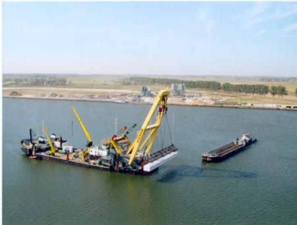
Foto 8: Exact gepositioneerd legschip zal de zand cement blokken nauwkeurig onder water plaatsen.
