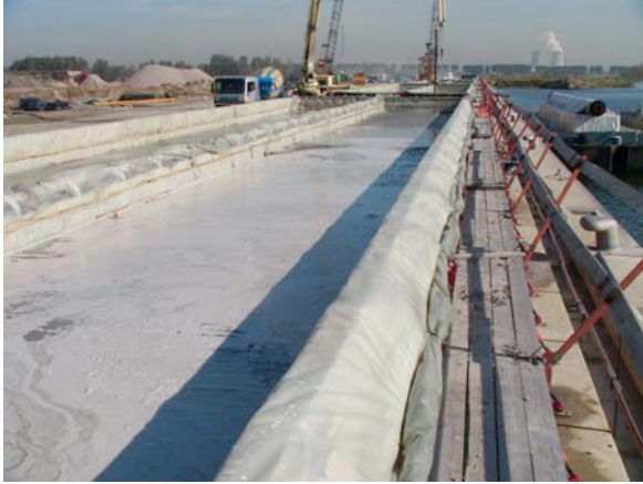
Foto 5: Het zand cement mengsel wordt gestort, daarna zal het geotextiel worden teruggeplooid en aan de zijkanten aan mekaar worden gestikt.
